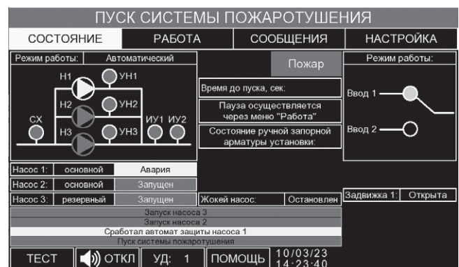
Рис. 15 Вид меню «Состояние» при поступлении сигнала на запуск
